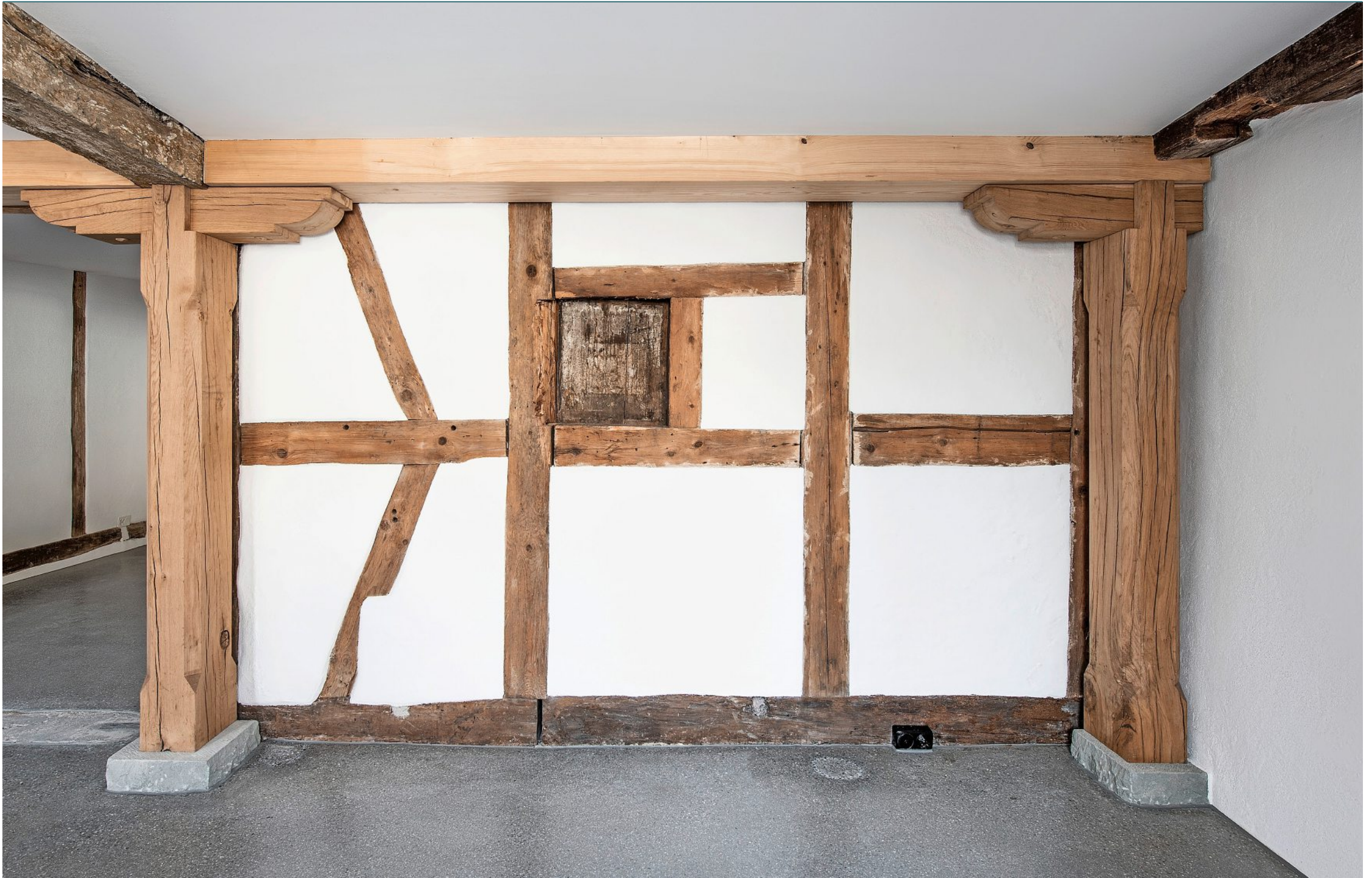
Das Innere von Altliegenschaften birgt oft viele Geheimnisse: Der Bohlenständerbau ist um das Jahr 1400 errichtet worden
